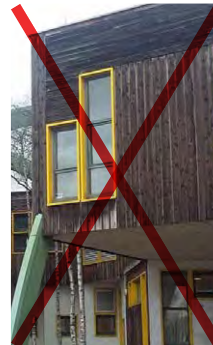
Vieillessement hétérogène du bois à éviter
