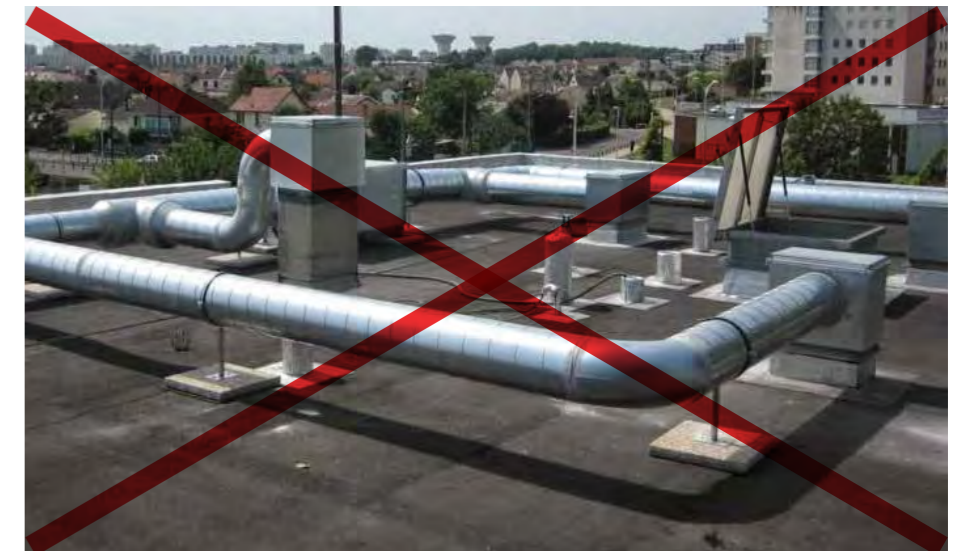
Les équipements techniques et édicules non intégrés au bâtiment sont proscrits
